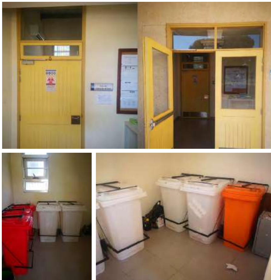
Figura 13: Sala de descarte de lixo, porta de saída e os recipientes de armazenamento de resíduos no edifício sede do INS, em Marracuene
